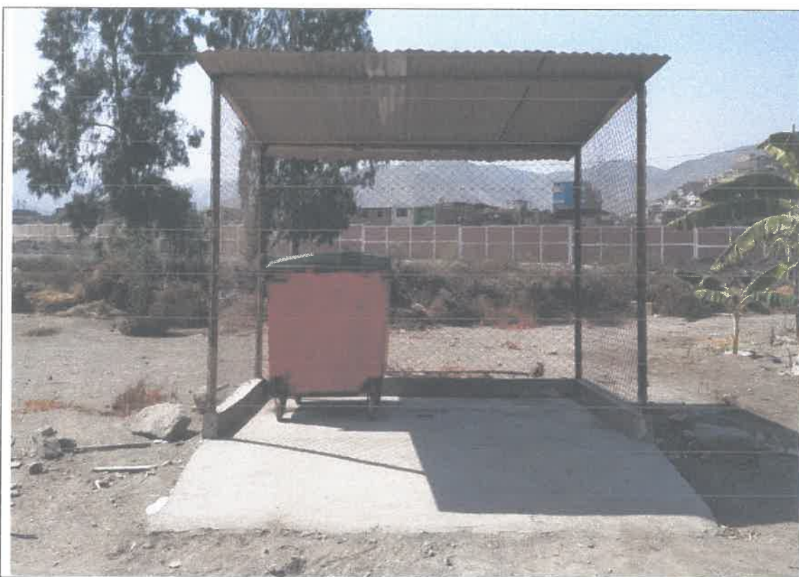
FOTOGRAFÍA N° 7. Almacenamiento intermedio N°3 de residuos sólidos (biocontaminados), no cuenta con aislamiento y tampoco con señalizaciones de seguridad.
